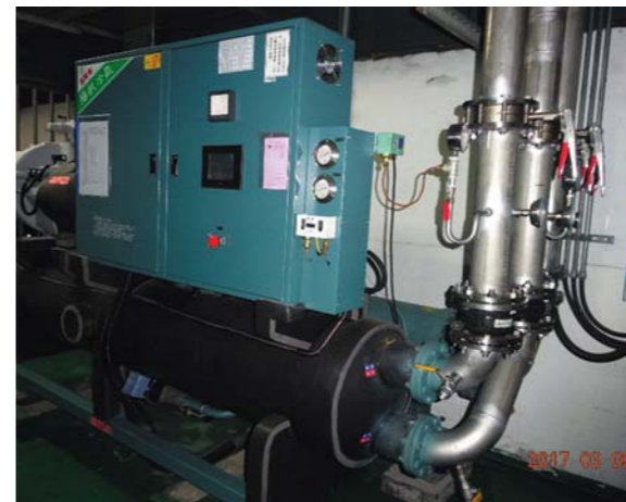
▲ 瑞芳礦泉水廠冰水主機房實景
