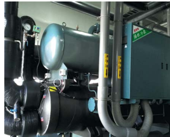
▲ 楊梅乳品廠冰水主機房實景
