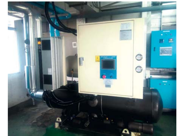
▲ 新市飲料一廠原汁製程冰水主機房實景
