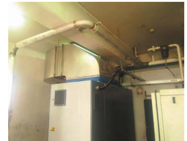
▲ 麻豆麵包廠空壓主機房實景
