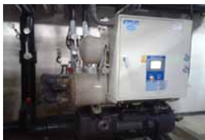
圖、台中辦公大樓鑫國 55RT 冰水機實景
