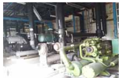
圖、冰品廠冰水主機房實景
