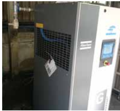
新營冷調廠 Atlas 空壓機實景
