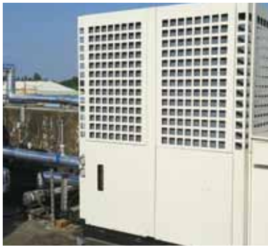
新營冷調廠鍋爐給水用熱泵主機實景
